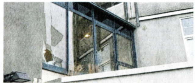
Trümmerteile des gesprengten Automaten flogen bis zur Seniorenwohnanlage und durchschlugen ein Fenster.
